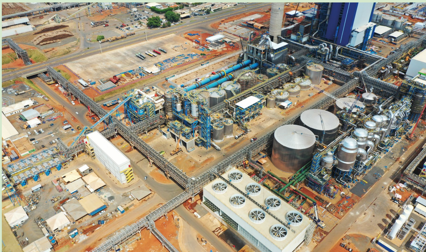
Bracell recebe a mais moderna e sustentável tecnologia de evaporação, incluindo uma fábrica de licor branco fornecida pela Valmet.
